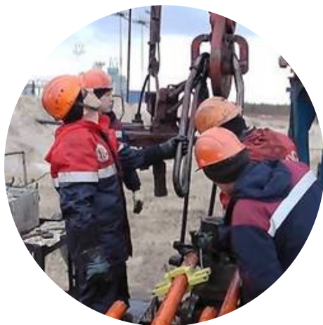
Комплексное обслуживание электропогружного оборудования
